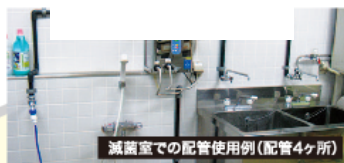
滅菌室での配管使用例(配管4ヶ所)
